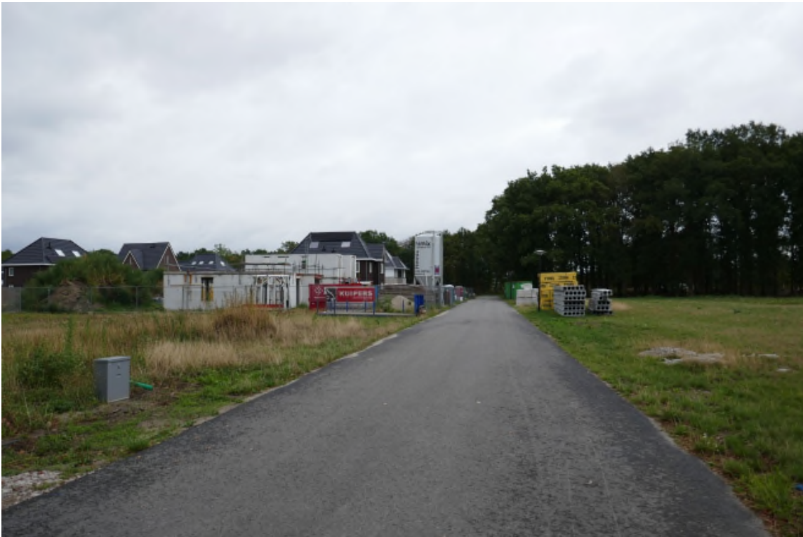
Bebouwing aan de Colenbranderstraat blok 6, gezien vanaf de andere zijde. Rechts blok 7.
