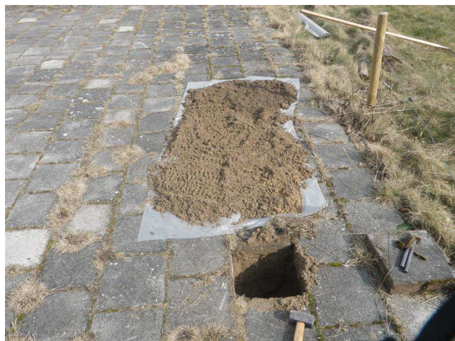
Foto 7: asbestgat bij boornummer 7
