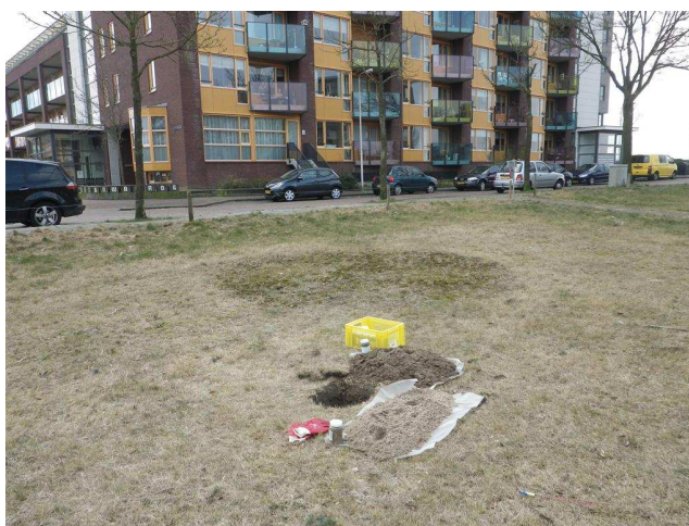
Foto 2: asbestgat bij boornummer 3
