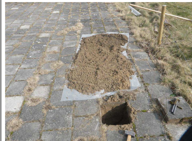
Foto 6: asbestgat bij boornummer 6
