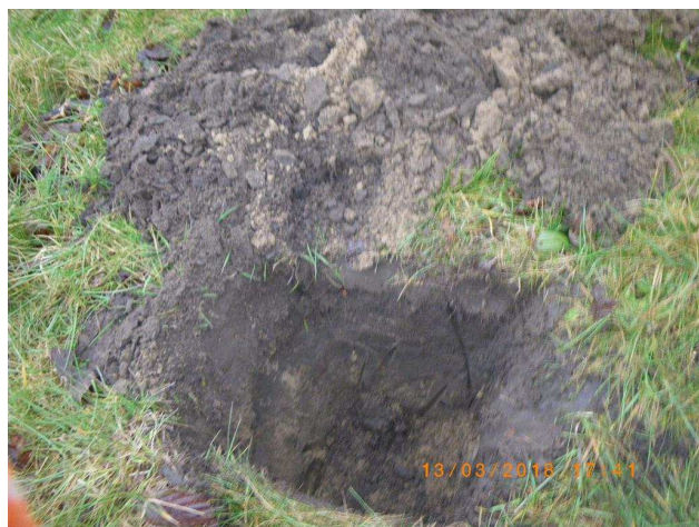
Foto 13: asbestgat bij boornummer 13
