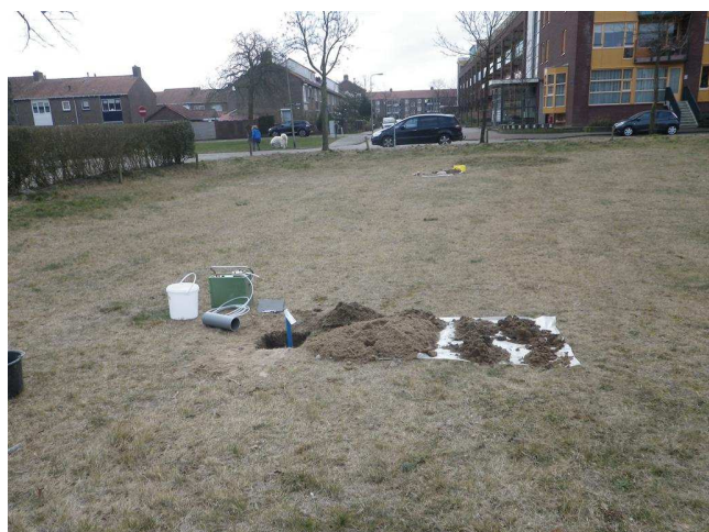
Foto 1: asbestgat bij boornummer 1
