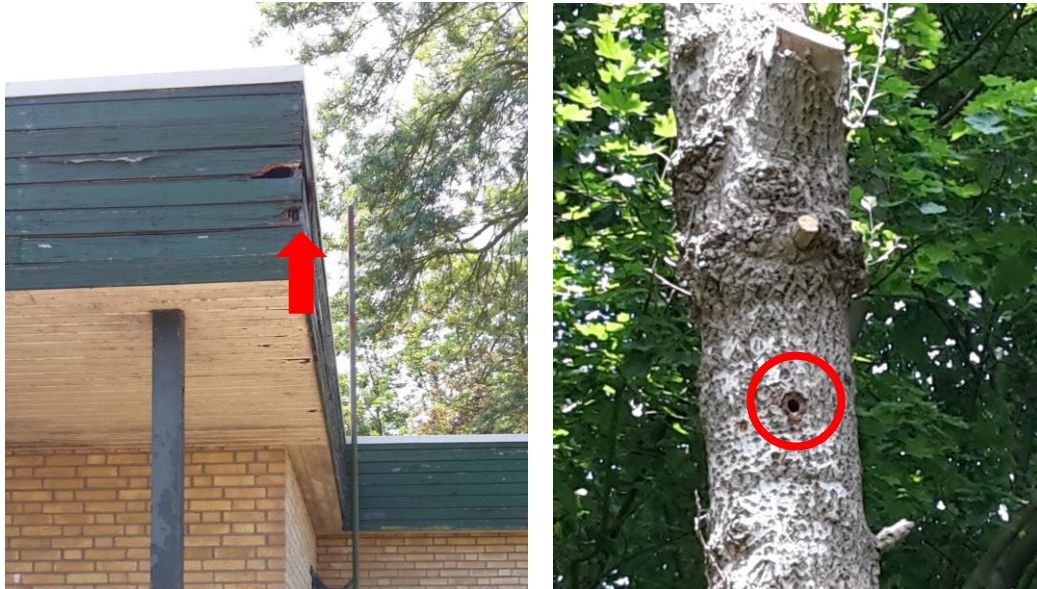
Figuur 3.3 en 3.4 Potentiële verblijfplaatsen van vleermuizen, in gebouw sportcomplex (rode pijl) en één van de bomen (rode cirkel). Foto's: Arno Kuipers, Ecogroen.
