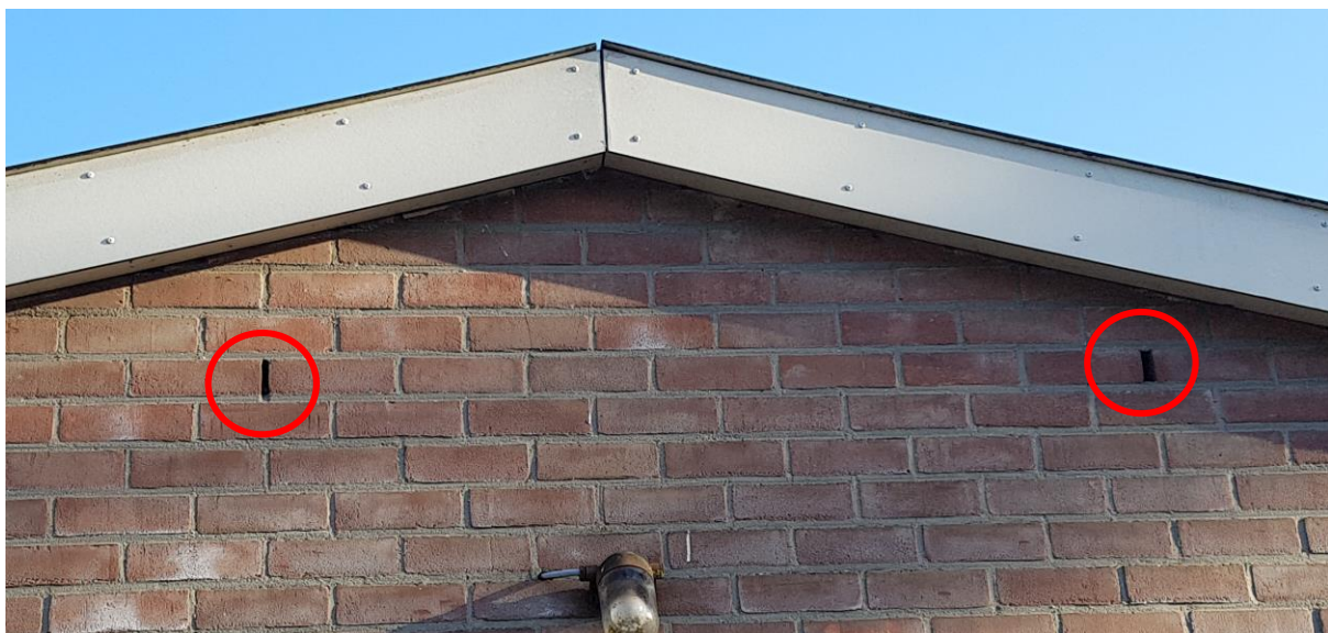
Figuur 5.8. Open stootvoegen (rood omcirkeld) in te slopen garagebedrijf die vleermuizen toegang bieden tot de spouw.
