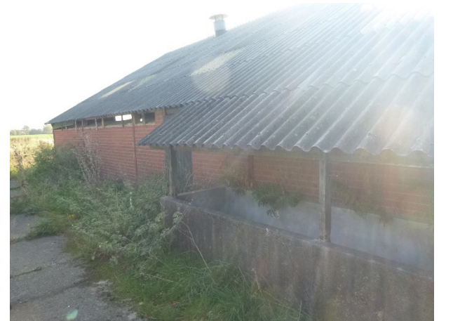
Druppelzone A en lekbak voormalige diesel-tanks met overkapping
