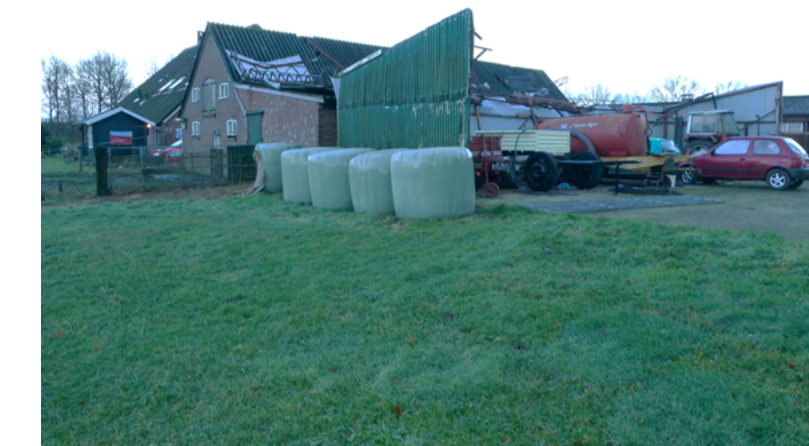
Schuur 3 (met stormschade)
