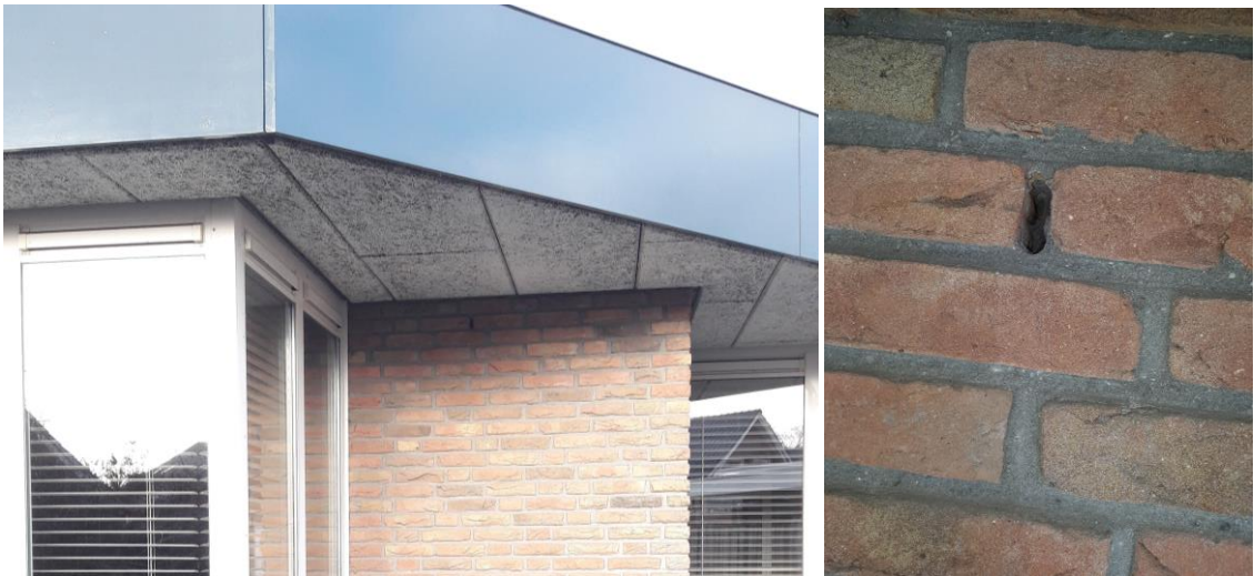
Figuur 3.1 Potentiële invliegopeningen voor vleermuizen in de vorm van open stootvoegen.
