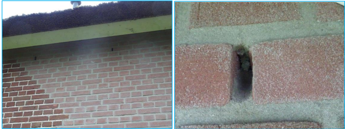
Foto's: Open stootvoegen en ongeschiktheid van de stootvoegen voor vleermuizen.
