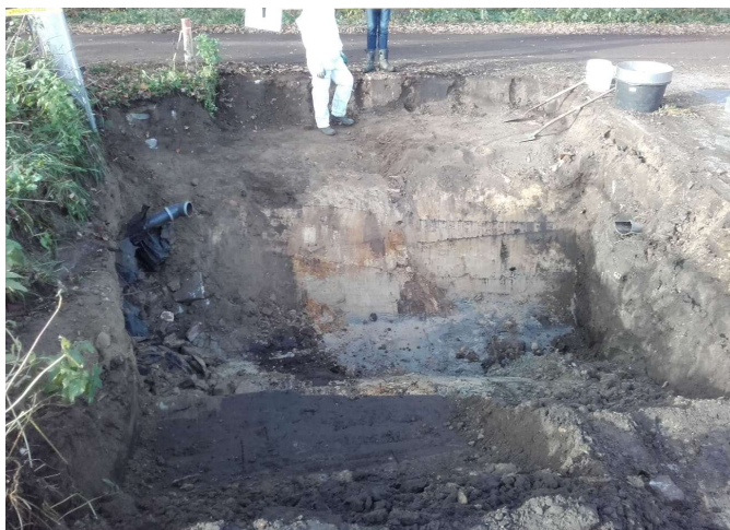
foto 3: Gedempte sloot en wanden W1-1/W1-2 (30-11-2018)
