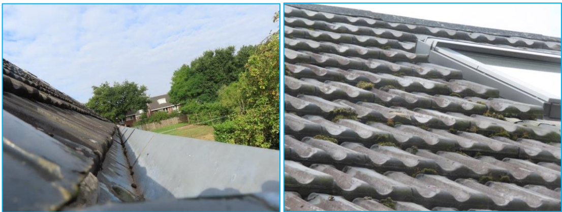
Foto's: Ongeschiktheid dak voor huismus en gierzwaluw.
