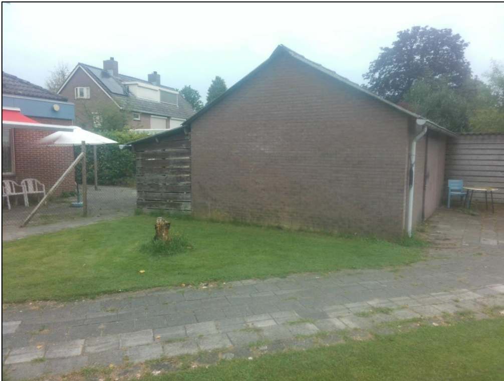
Foto 5: asbestverdacht dak (westzijde)
