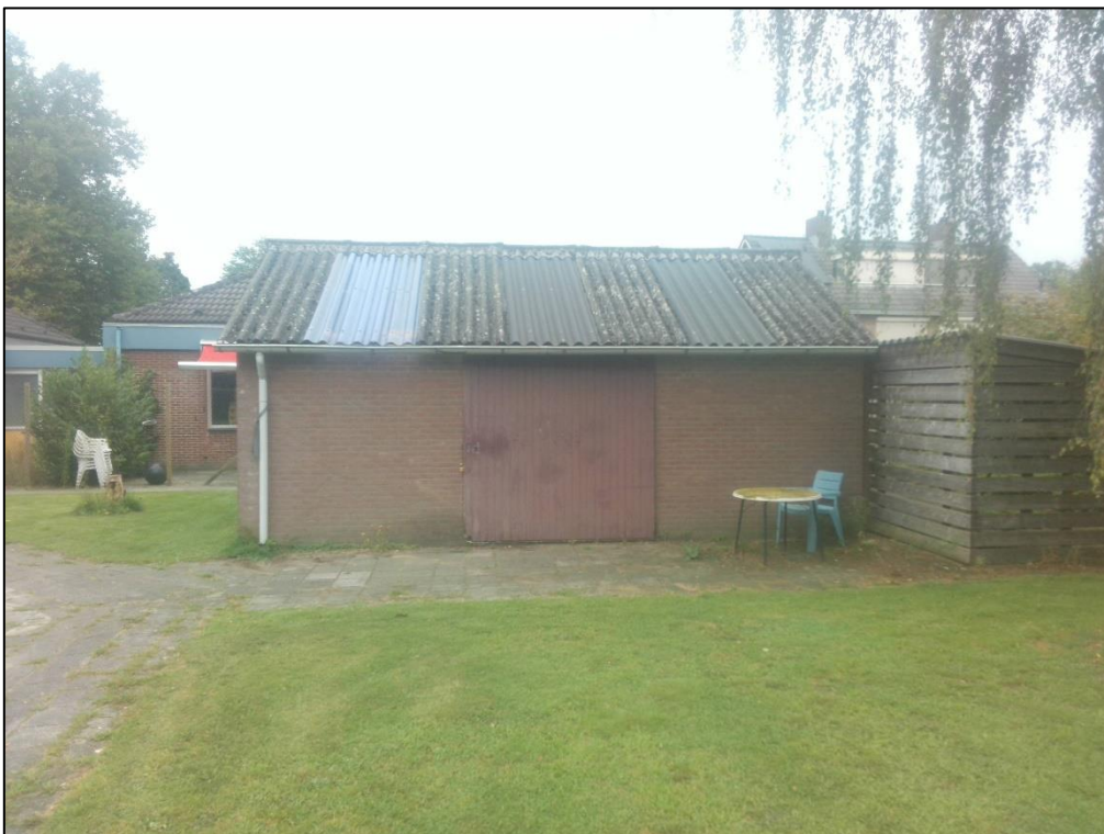
Foto 4: asbestverdacht dak (zuidzijde)
