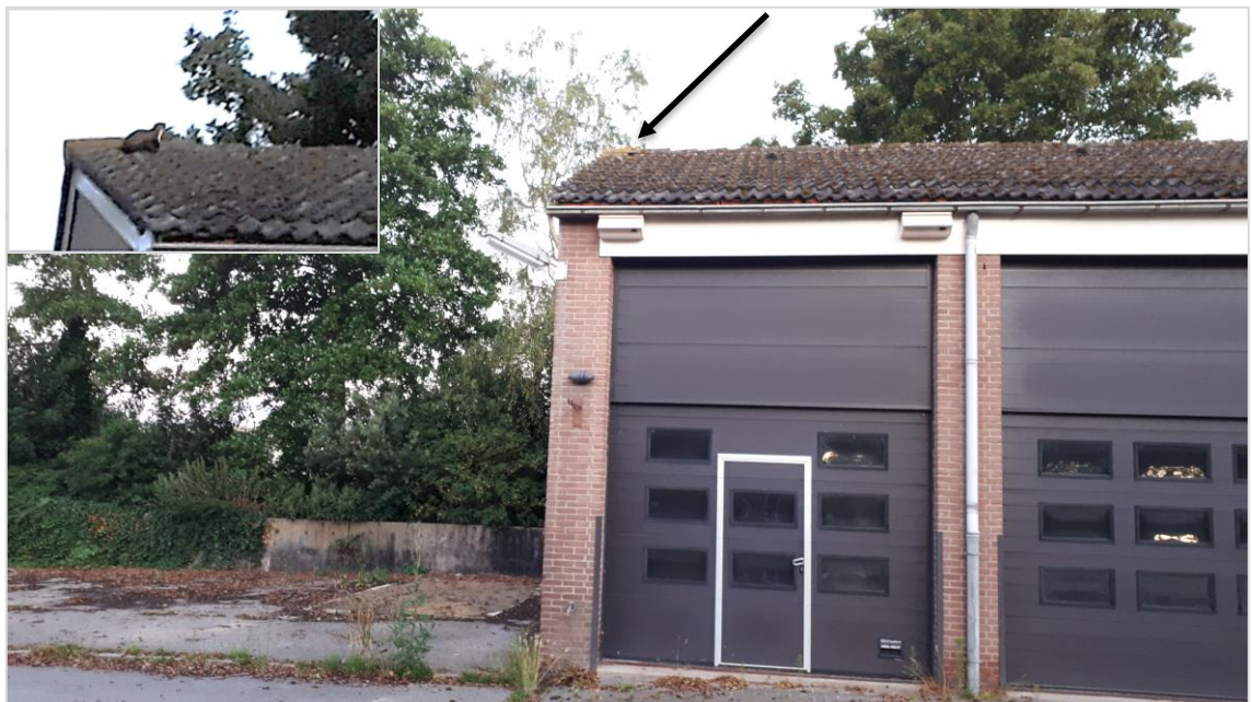
Figuur 4.4 De zwarte pijl geeft aan waar de verblijfplaats van steenmarters zich bevindt: In het gat bij de eerste nokpan en onderliggende dakpannen. Inzet: uitsnede van video still opname smartphone van steenmarter bij verblijfplaats op 7 juli 2020. Bron foto's: Bastiaan Tolkamp, Ecogroen.
