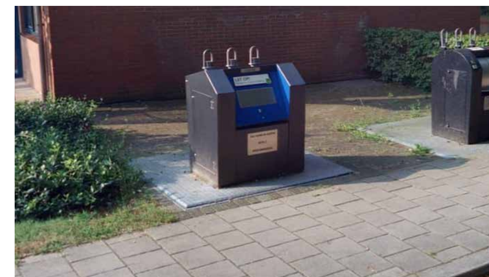
Referentie ondergrondse containers Burgemeester Doffegnieslaan
