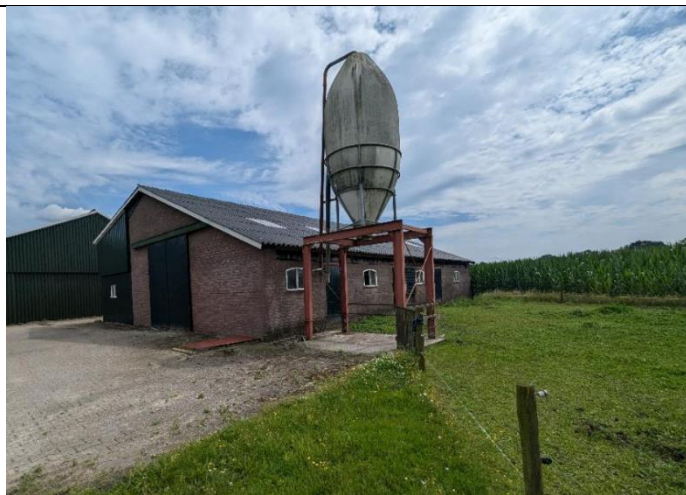
figuur 5: asbestdak zonder dakgoot
