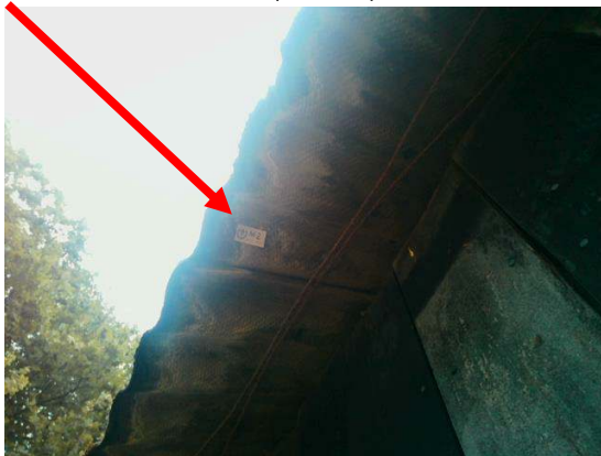
Foto 5 | Golfplaten op het dak
