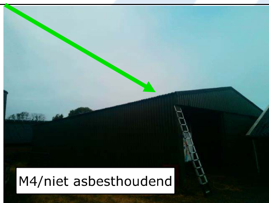
Foto 10 | Golfplaten op het dak
