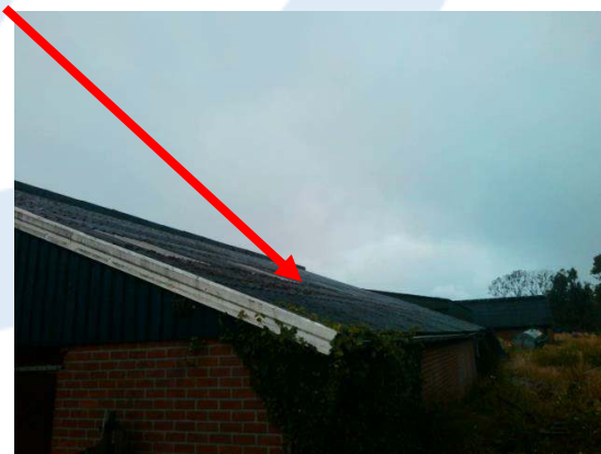
Foto 7 | Golfplaten op het dak
