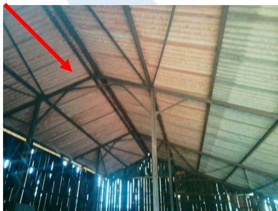
Foto 1 | Golfplaten op het dak
