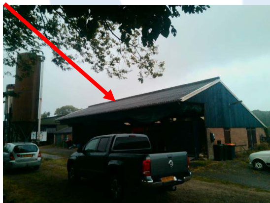
Foto 6 | Golfplaten op het dak
