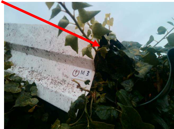
Foto 9 | Golfplaten op het dak
