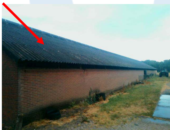
Foto 19 | Golfplaten op het dak
