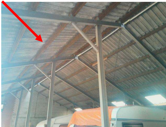
Foto 8 | Golfplaten op het dak
