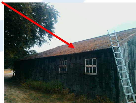
Foto 2 | Golfplaten op het dak
