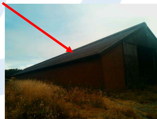
Foto 20 | Golfplaten op het dak
