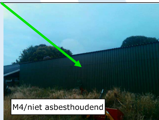
Foto 11 | Golfplaten op het dak
