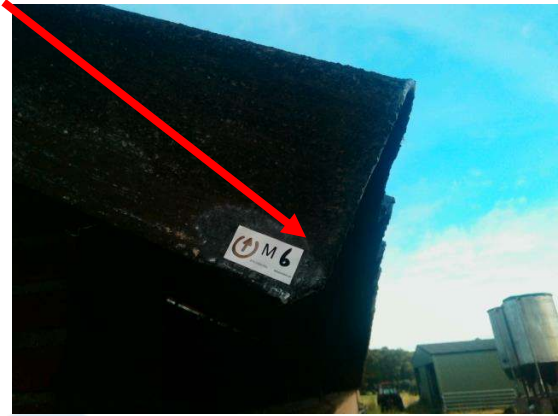
Foto 22 | Golfplaten op het dak
