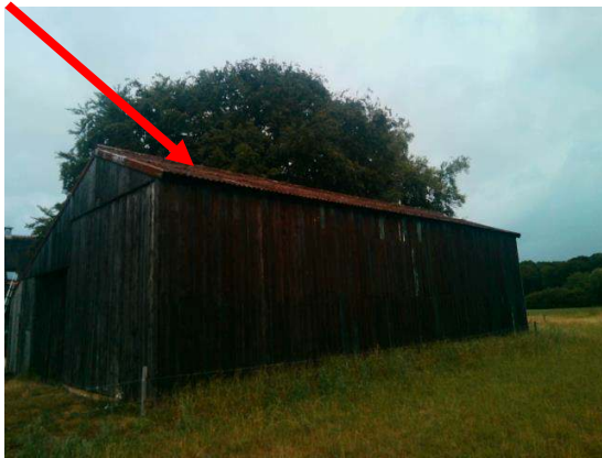
Foto 3 | Golfplaten op het dak
