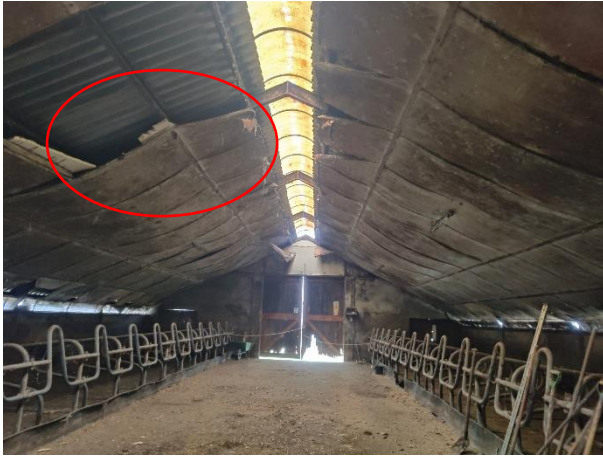
Verblijfplaats van steenuil tussen het dakvlak en loshangende isolatieplaten in de varkensstal.
