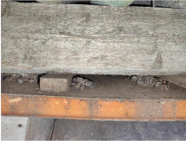
Latrine van een steenmarter onder het dakvlak van de varkensstal.
