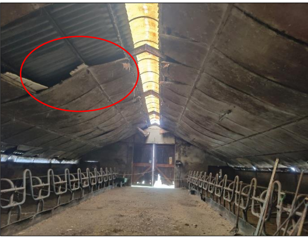
Verblijfplaats van steenuil tussen het dakvlak en loshangende isolatieplaten in de melkveestal.
